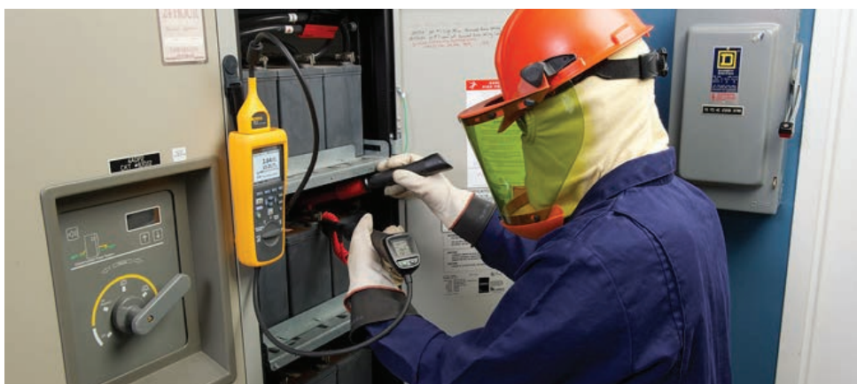
使用 Fluke BT500 测量内阻, 每个季度进行每块电池/单元的内阻测试。
